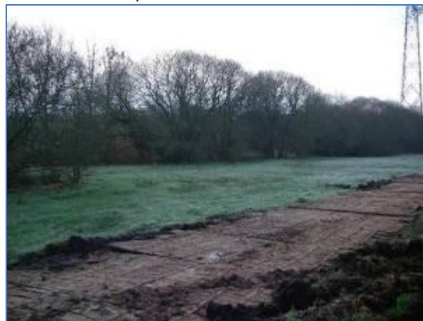
Figure 43 : Exemple d'un cheminement provisoire en bois qui protège le sol de la parcelle (bassin du Rion, chantier ERDF)
